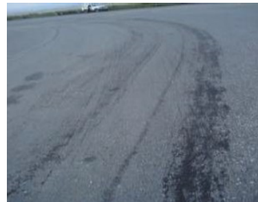
(d) Bleeding on exit taxiway ET5
